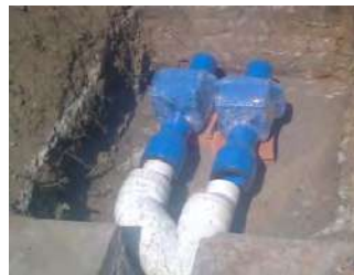
Figura 5.14. Válvulas check para evitar el regreso de agua del drenaje a la cisterna.
