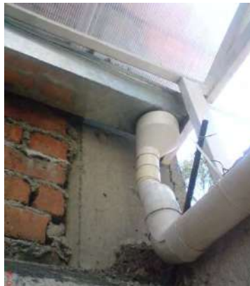
Figura 5.2. Canaleta de zinc y tubería de PVC.
